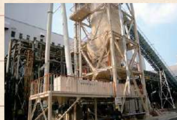
▲バイオ燃料風送設備
