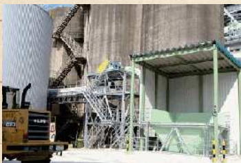
▲RPF燃料 受入・払出し設備
