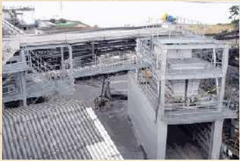
▲スラッジ 受入・払出し設備
