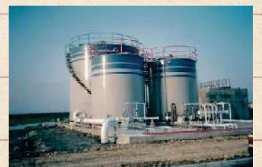
▲純水タンク・処理タンク
