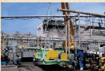
▲プラスチック燃料粉砕・風送設備
